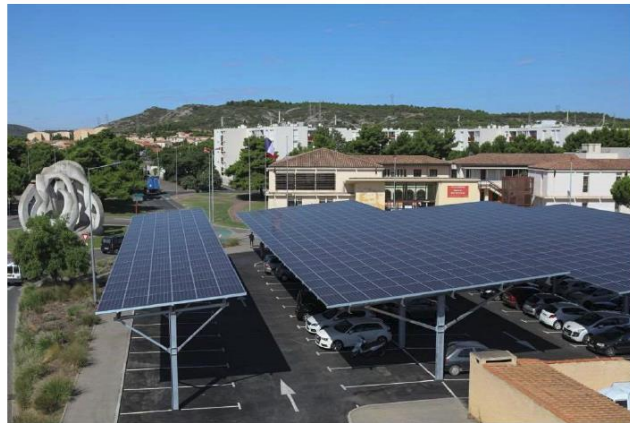
Ombrières, installées mi-2018, sur le parking Saint-Jean Saint-Pierre à Narbonne
