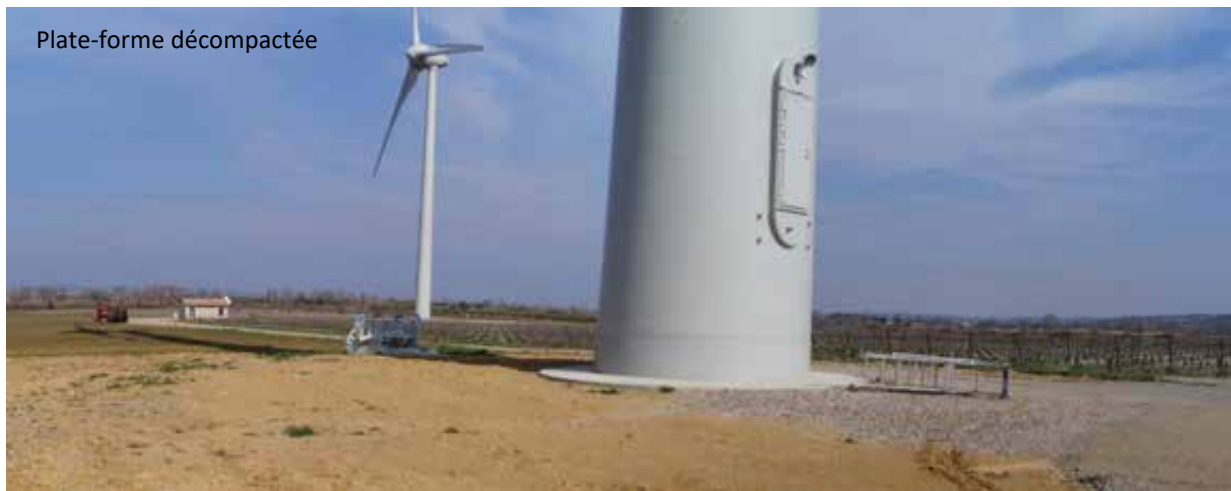
Poste de livraison et éoliennes de Villedaigne
