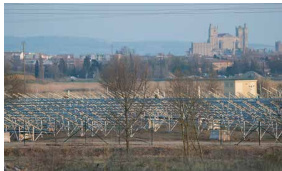
Photo 11 : parc solaire en construction en zone humide périurbaine proche de Narbonne (photo : S.ALBΟΥY, février 2018)
