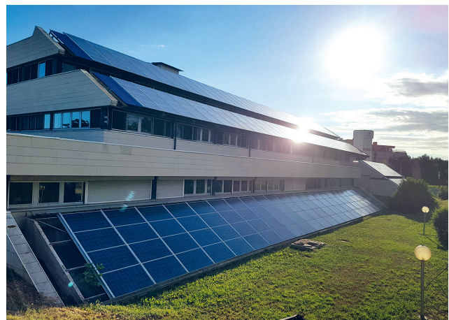
Installation solaire de 112 kWc sur le bâtiment de l'INESS à Narbonne Production de 130 MWh/an © Le Grand Narbonne
