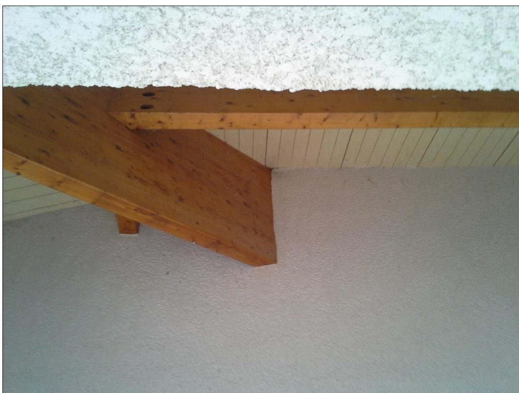
Anfruosité dans la structure du bâtiment. Cet accès est apparemment utilisé par les nombreux chiroptères présents autour de ce bâtiment, comme en témoigne la quantité importante de guano observé au sol, sur les poutres, murs, ... Des traces brunes sur le crépi témoignent du passage d'individus par cet accès (X. Leal)
